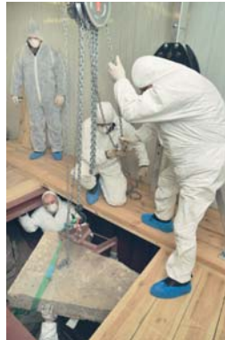
04.jpg Arbeitsfoto: Anhebung der ersten Deckplatte des Erzbischofsgrabs mit Hilfe eines Flaschenzugs. (Foto: Andrea Hörentrup, LDA Sachsen-Anhalt)
