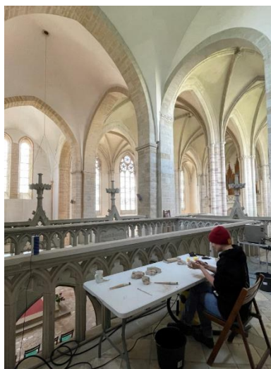
Abbildung 4: Blick auf den Arbeitsplatz auf der Nordempore der Klosterkirche St. Marien und Cyprian in Nienburg. © Fachhochschule Potsdam, Tobias Breu.
