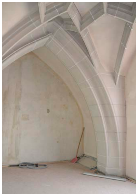
HALLE (SAALE), MARKTKIRCHE ST. MARIEN, GEWÖLBE DER NW-ECKE (OBEN) UND HISTORISCHE KLAMMERSICHERUNG (UNTEN)
