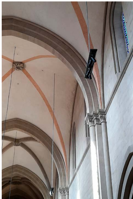
NAUMBURG, BURGENLANDKREIS, DOM, ERNEUERUNG DER BELEUCHTUNG IM LANGHAUS
